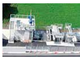
▲安永雨水ポンプ場
