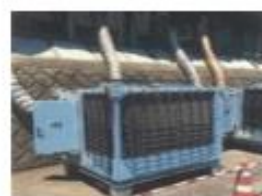
エアコン(室外機)
