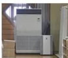
エアコン(室内機)
