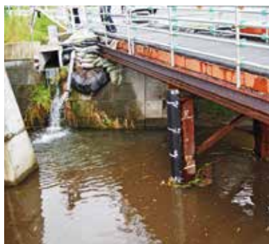
内水氾濫を起こした福富橋仮橋
