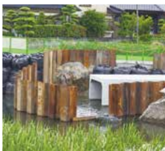
出水期に入った安永雨水ポンプ場
