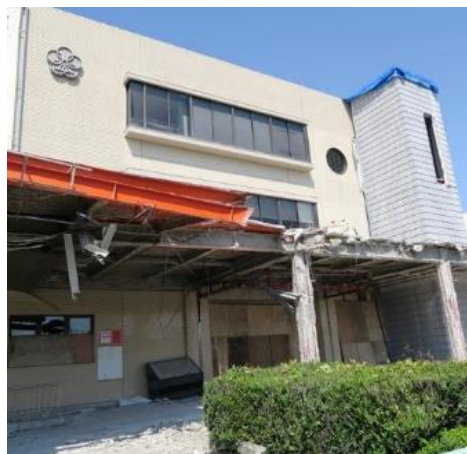
庁舎は甚大な被害を 受けて解体へ
