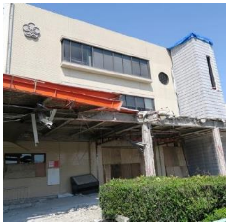
庁舎は甚大な被害を 受けて解体へ
