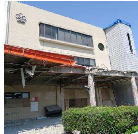
庁舎は甚大な被害を 受けて解体へ
