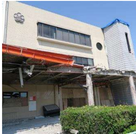
庁舎は甚大な被害を 受けて解体へ
