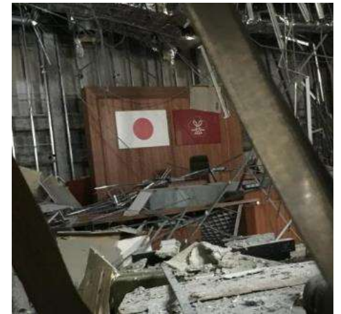
議場は特に被害が大きく 立ち入れない状態
