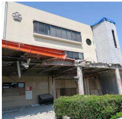
庁舎は甚大な被害を 受けて解体へ
