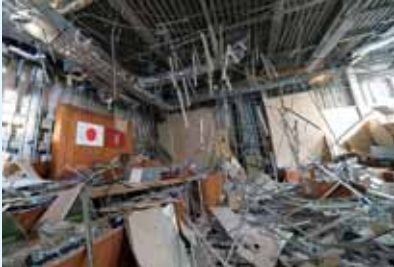
天井が落下した議会棟本会議場
