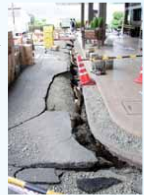
大きく損傷した役場庁舎の基礎
