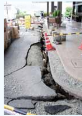
大きく損傷した役場庁舎の基礎
