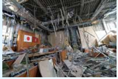
天井が落下した議会棟本会議場
