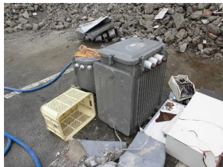
見つかった変圧器
