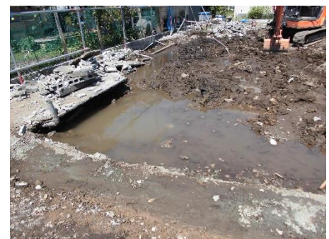
基礎の下から湧水した地下水
