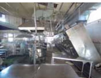
設備が激しく損傷した調理室内
