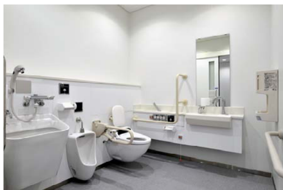
多目的トイレの例
