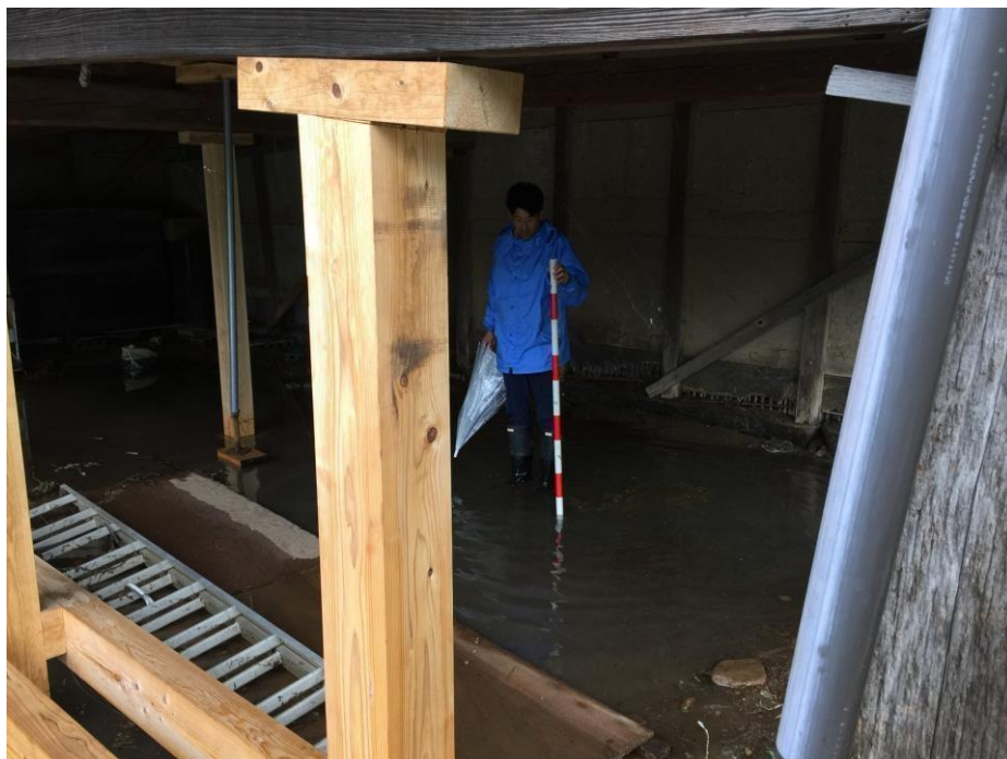
納屋内水没状況(谷川地区)
