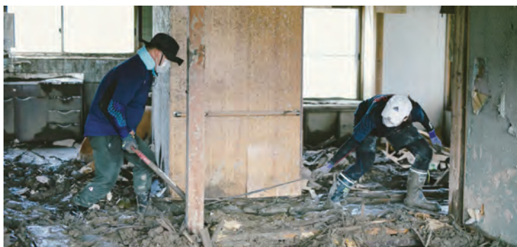
県南豪雨災害の復旧ボランティア
