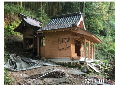
地震後の本殿と拝殿
