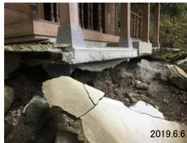
盛土と裏込が流出した基礎
