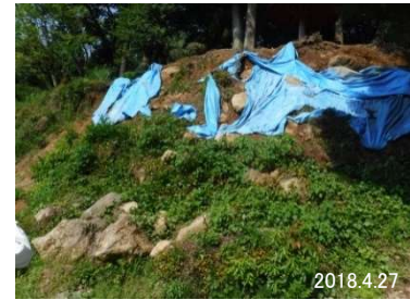
図 5-8 崩落した法面
