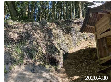
落石防護ネット
