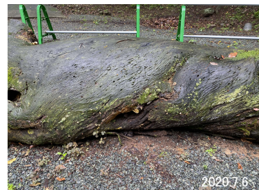
シロアリによる被害
