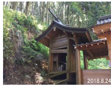
本殿裏の土砂崩落
