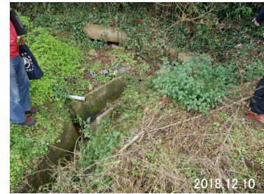
右横ずれした水路(東側)
