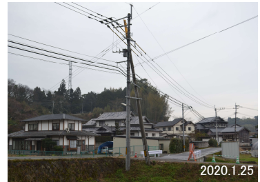
図 5-15 傾倒した電柱
