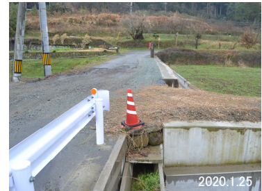
右横ずれした水路(南西側)
