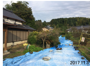
養生シート(ブルーシート)
