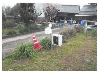
設置状況(谷川地区:庭)
