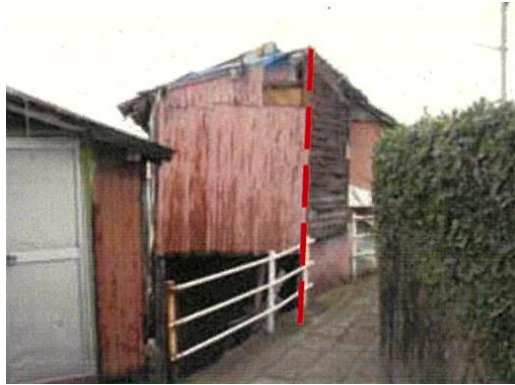
一部の柱が傾斜している例
