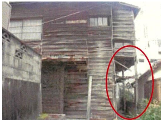
柱の数箇所に破損がある例
