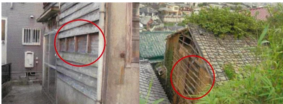
外壁の仕上材の一部がはがれ、下地が露出している例
