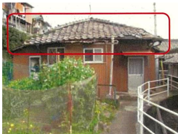
屋根に不陸がある例
