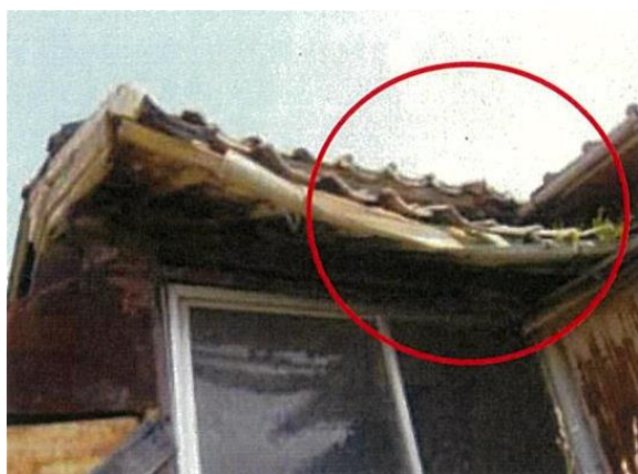
軒の裏板、垂木等が腐朽し、 軒が垂れ下がっている例
