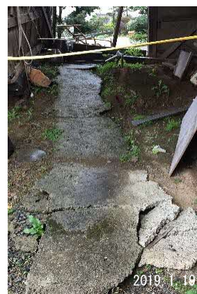
㉒ 谷川 コンクリート舗装に表れた褶曲
