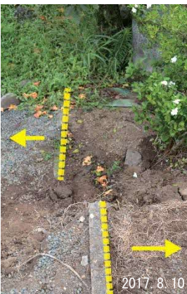
㉔ 谷川 左横ずれした水路
