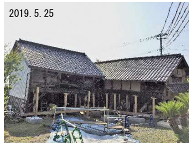
谷川 納屋と仮設見学路
