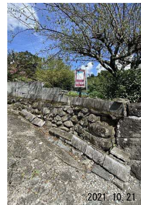
㉓ 谷川 被災した石垣とブロック塀
