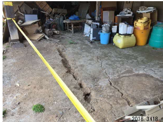
⑳ 谷川 地表地震断層 納屋2 内部
