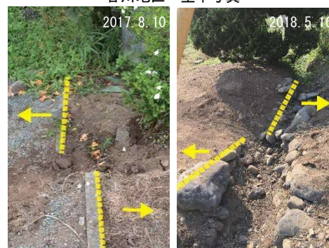
左横ずれした水路 ① 右横ずれした水路 ②
