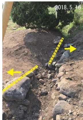
㉕ 谷川 右横ずれした水路
