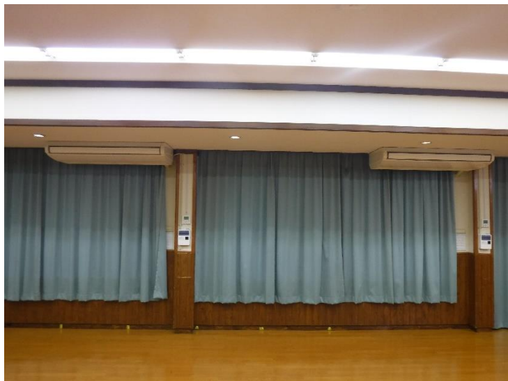
福田分館 講堂空調機 コインタイマー
