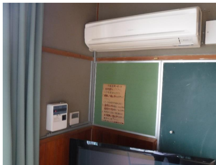
福田分館 和室空調機 コインタイマー
