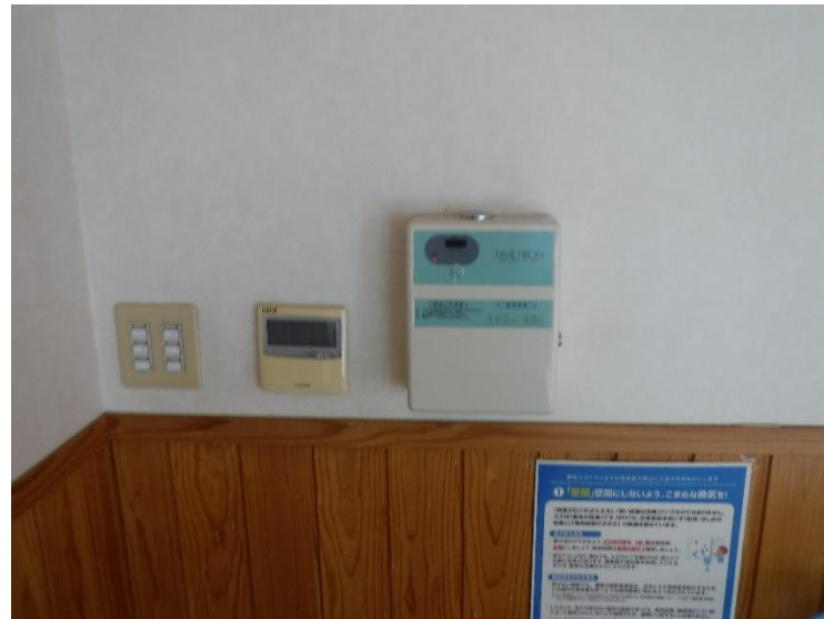
飯野分館 講堂空調機 コインタイマー
