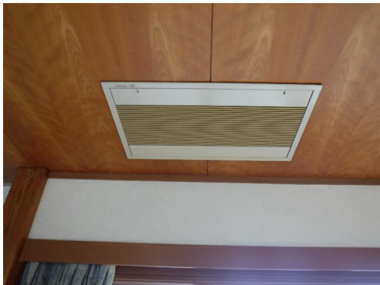
飯野分館 講堂空調機
