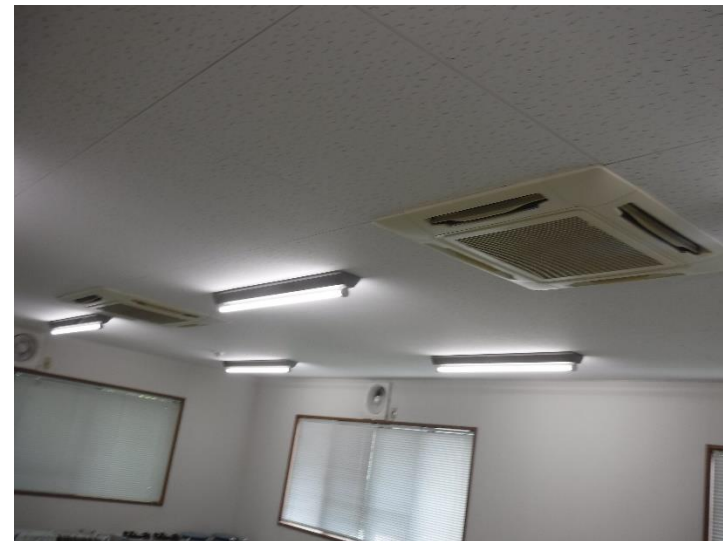
飯野分館 調理室 空調機
