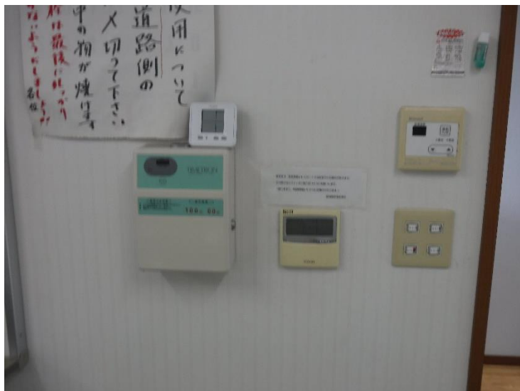
飯野分館 調理室 空調機 コインタイマー
