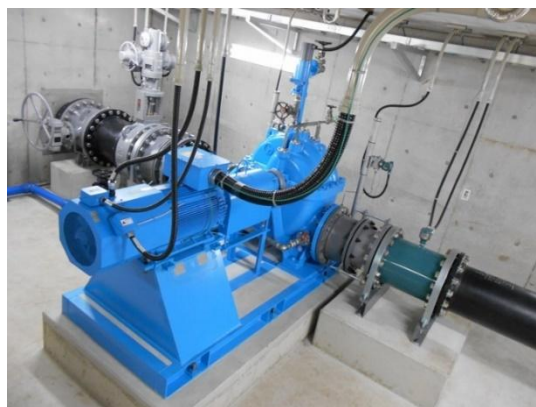
小水力発電（戸島送水場） 出典：熊本市
