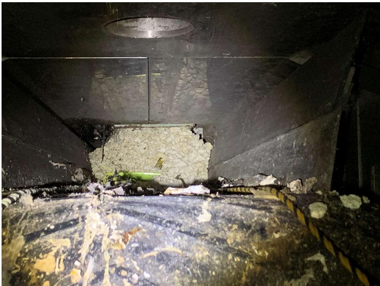
●町浄化センター内沈砂池内 オイルボール1
