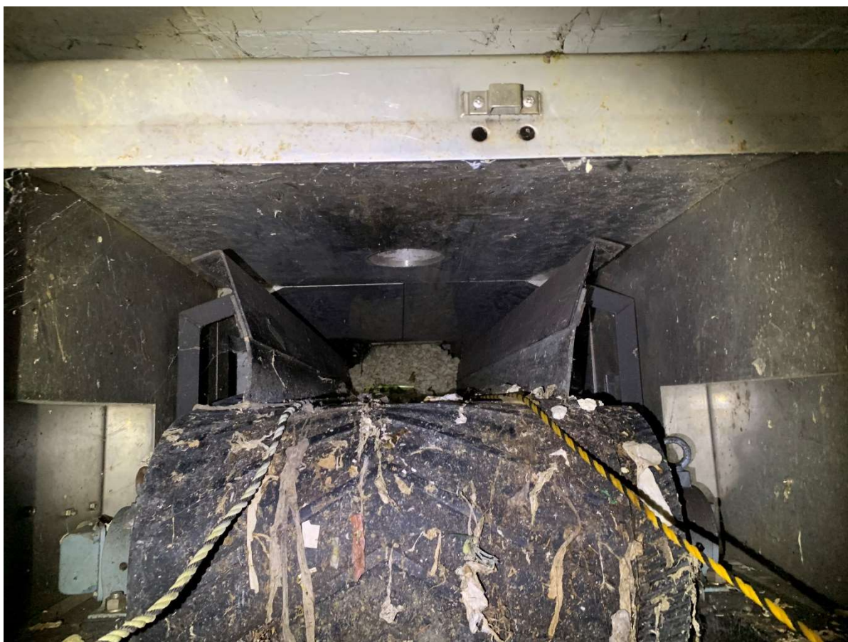
●町浄化センター内沈砂池内 オイルボール2
