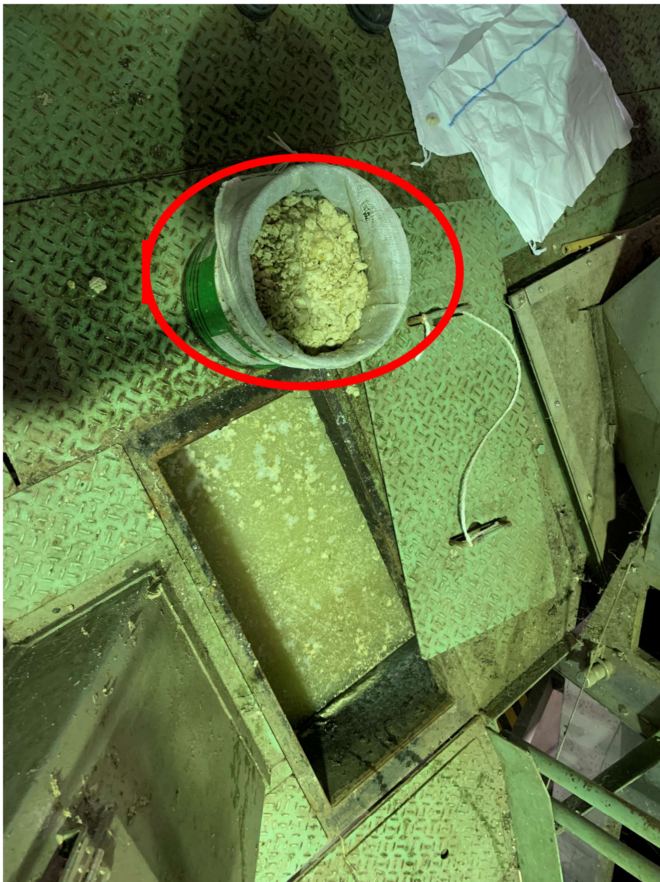
●町浄化センター沈砂池内 オイルボール (赤丸内)
