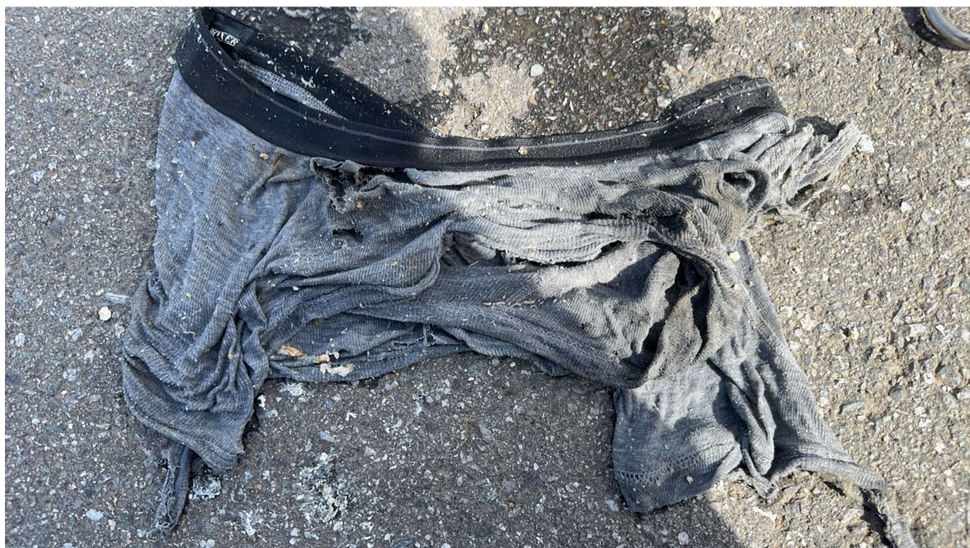
●マンホールポンプ異物混入例(ボクサーパンツ)
