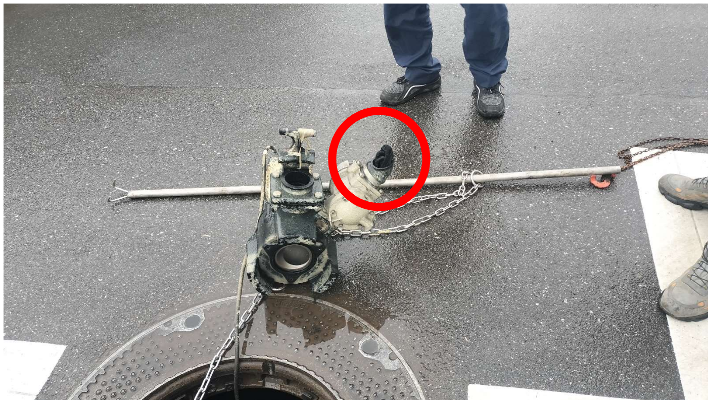
●マンホールポンプ異物混入に伴う部品取り外し(赤丸内のつまりに伴う)
