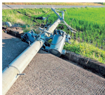
倒れた電柱。各地で停電が起こった
