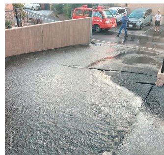
割れた道路から流れ出した水
