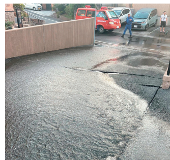
割れた道路から流れ出した水
