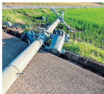
倒れた電柱。各地で停電が起こった
