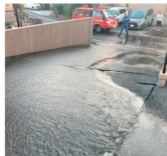
割れた道路から流れ出した水
