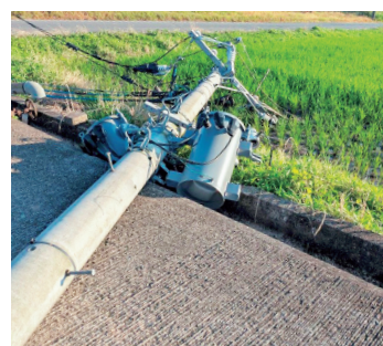
倒れた電柱。各地で停電が起こった
