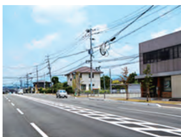
県道沿いの電線垂れ下がり
